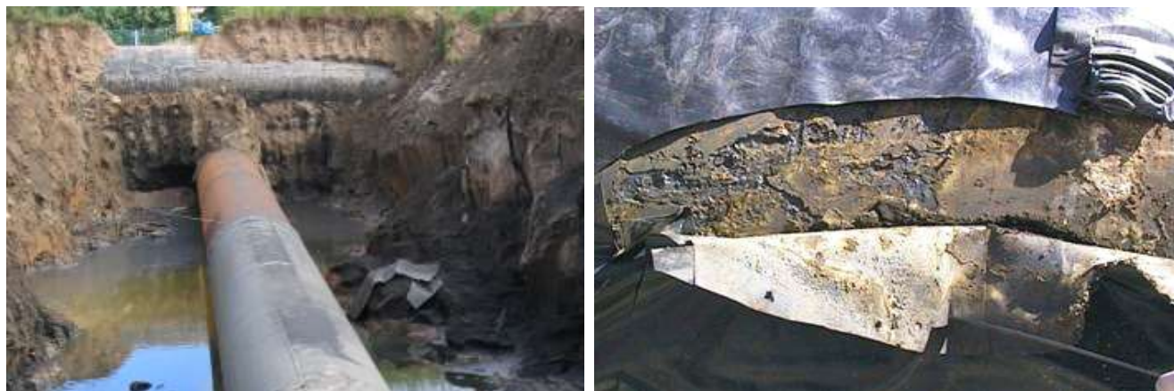
а – пересекающиеся трубопроводы; б – коррозионные повреждения металла трубопроводов под покрытием из полимерных лент
